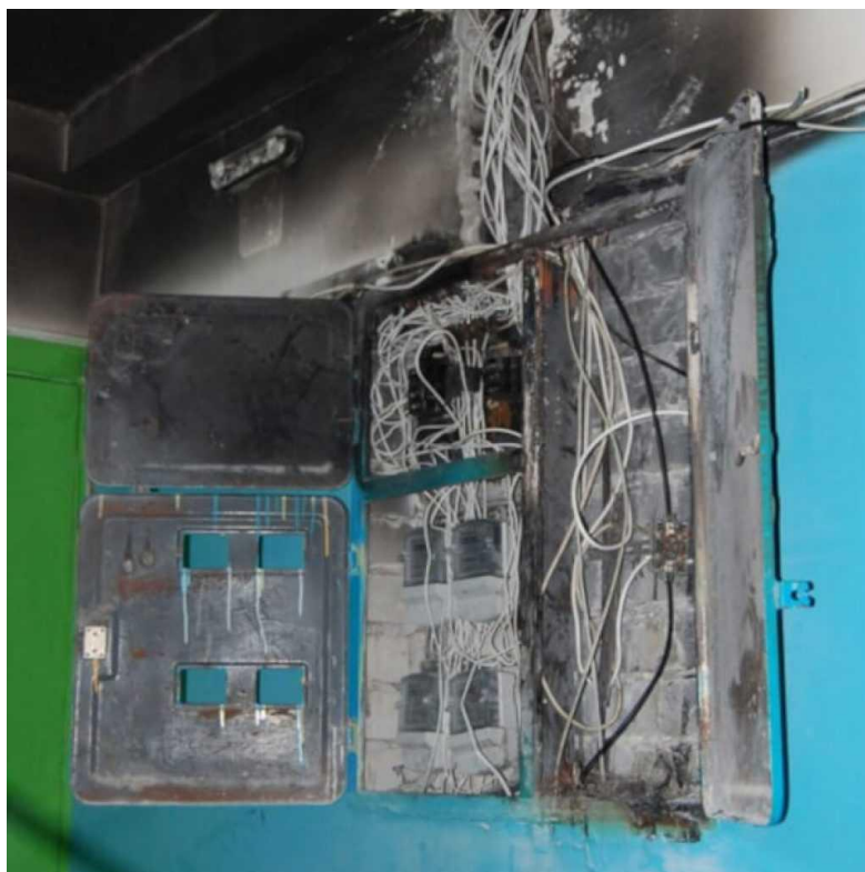
Рис. 10. Короткое замыкание в электросети
