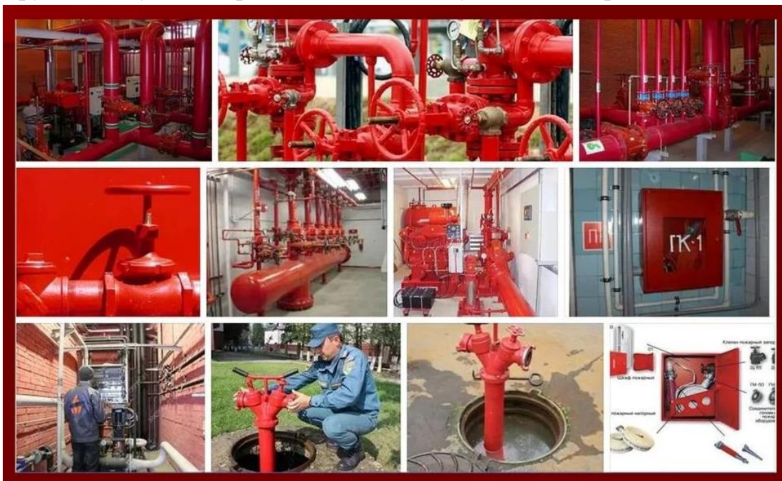
Рис. 21. Источники наружного и внутреннего противопожарного водоснабжения
